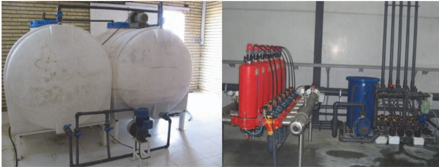
شکل ۲۱- تأسیسات آبیاری در گلخانه
